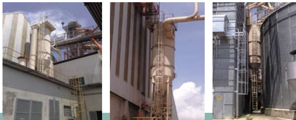
Sistemas de filtragem nas áreas de recebimento de caminhões, pesagem, pré-limpeza e secagem.
