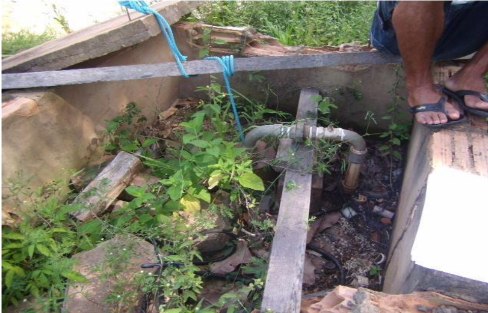
FOTO 4.2-36: Poço tubular da unirios.
