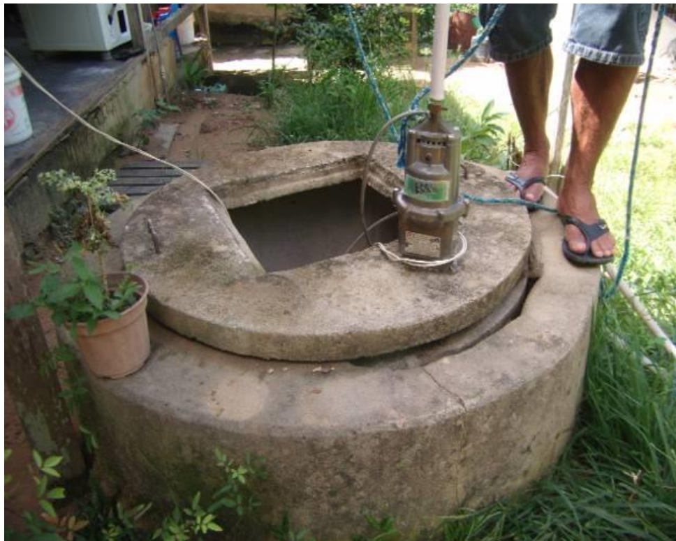
FOTO 4.2-35: Poço amazonas da área do empreendimento.
