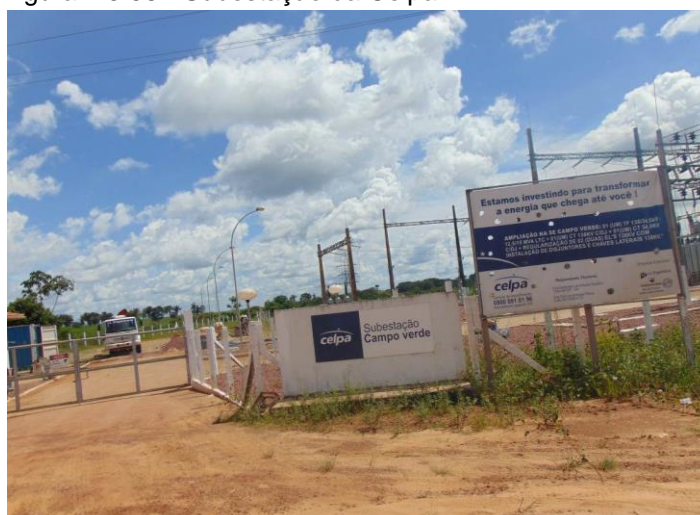
Figura 7.3.58 - Subestação da Celpa.
