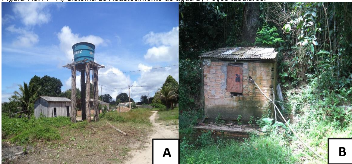
Figura 7.3.14 - A) Sistema de Abastecimento de água B) Poços tubulares.
