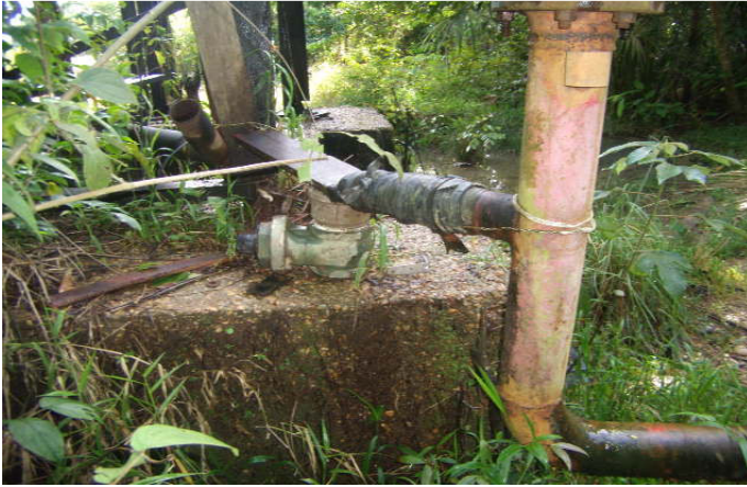
Poço tubular da Petrobrás (P2). Fonte: EIA / RIMA ETC Terfron, 2010.
