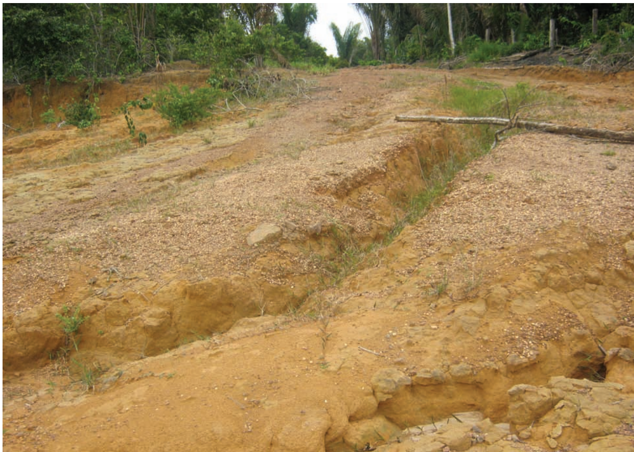
Terreno sem presença de vegetação desenvolvendo processo erosivo devido a ação das chuvas
