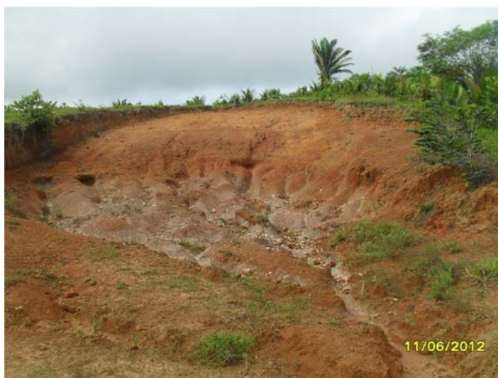
Figura 20. Erosão em caixa de empréstimo onde os sedimentos argilosos cascalhentos foram retirados para construção de estrada.
