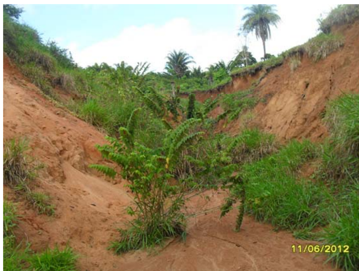
Figura 19. Aspecto de voçoroca formada em terreno arenoso da Cobertura Superficial Cenozoica constituída por depósito aluvionar holocênico à margem do rio Tapajós na ADA da ETC Rurópolis.
