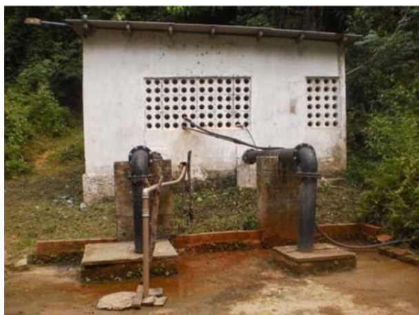
Figura 71. Captação de água em Rurópolis. Outubro/2011.
