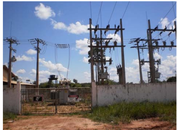
Figura 103. Substação da rede de energia em Rurópolis. Outubro/2011.
