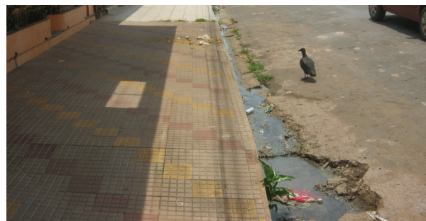
Figura 41 - Exposição de esgoto sanitário.
