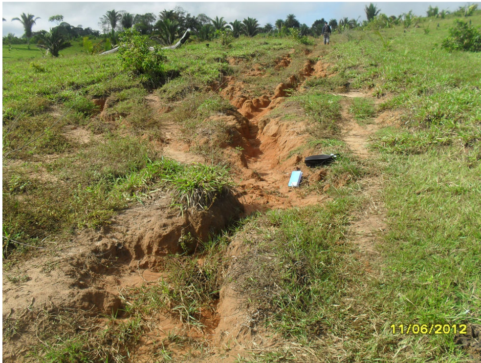
Figura 21. Aspecto de processo erosivo que se desenvolve em terrenos do Planalto Residual do Tapajós em áreas marginais da BR-364 margem esquerda do rio Tapajós.
