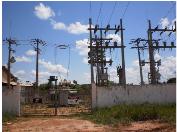
Figura 104. Subestação da rede de energia em Rurópolis.
