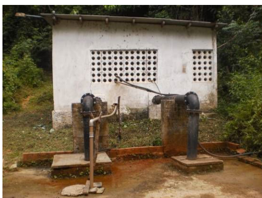
Figura 71. Captação de água em Rurópolis.
