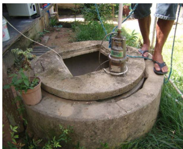
Figura 45: Poço amazonas (P1). Fonte: TERFRON, 2010.
