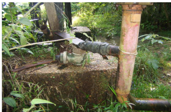
Figura 44: Poço tubular da Petrobrás (P2). Fonte: TERFRON, 2010.
