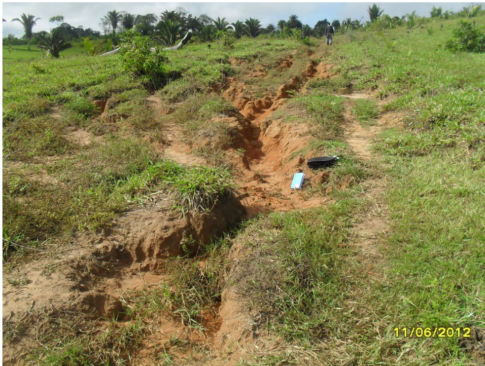
Figura 23. Aspecto de processo erosivo que se desenvolve em terrenos do Planalto Residual do Tapajós em áreas marginais da BR-364 margem esquerda do rio Tapajós.
