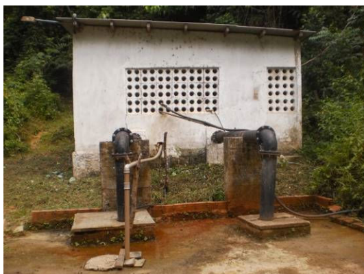
Figura 298. Captação de água em Rurópolis. Outubro/2011.
