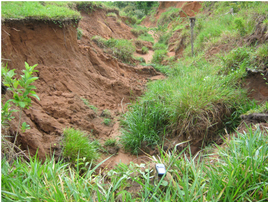
Figura 44. Aspecto das áreas que sucedem aos barrancos marginais ao rio Tapajós no interior da ADA do empreendimento.
