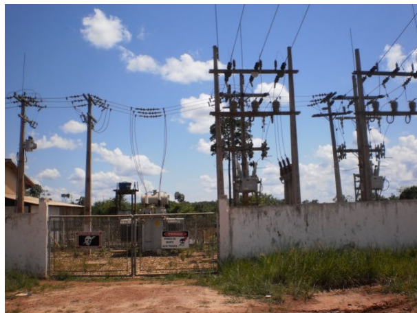
Figura 330. Substação da rede de energia em Rurópolis. Outubro/2011.
