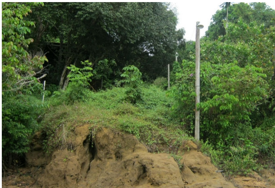
Figura 16. Aspecto de processo erosivo registrado no Planalto Residual Tapajós nas proximidades da margem esquerda do rio Tapajós, município de Itaituba.
